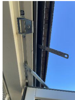
Ingen udvendig fuger over vinduer på kviste
