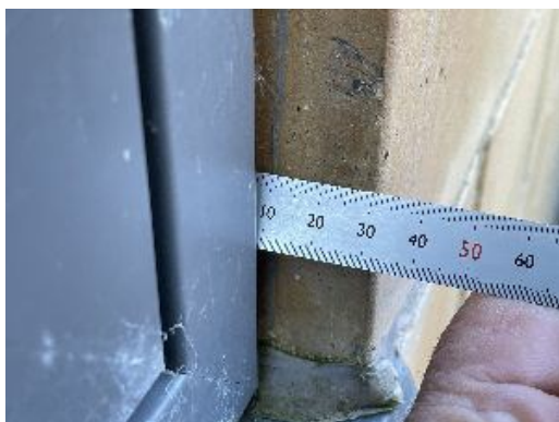
Vindue kun trukket ca. 25 mm tilbage i facaden
