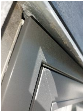
Ingen udvendig fuger over vinduer på kviste
